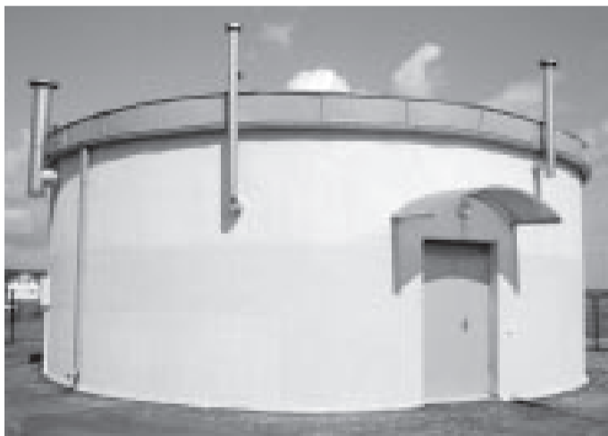
Насосная станция в районе ул. Нометню
